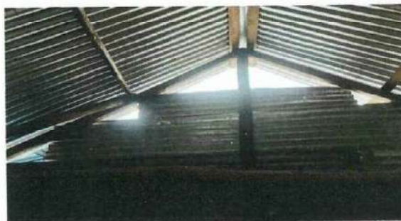
Foto 2: Paredes de cocina con lamina para permitir la ventilacion.
