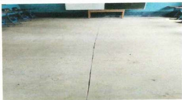
Foto 3: Vista de piso de concreto sin alisado.
