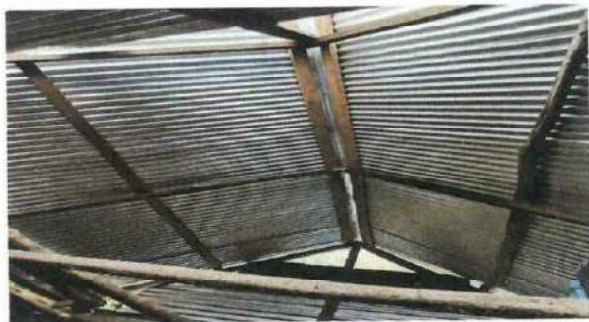
Foto1: Estructura de madera de cocina, deteriorado por humedad por viento y lluvia.
