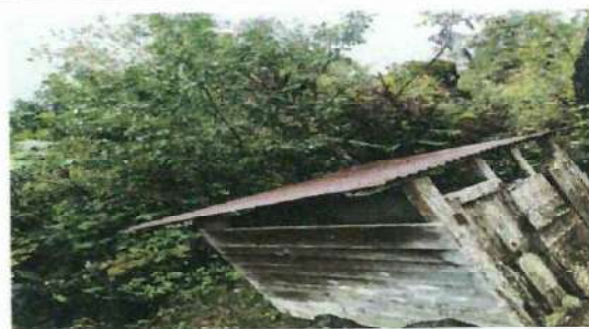
Foto 6: Cubierta del baño en mal estado.
