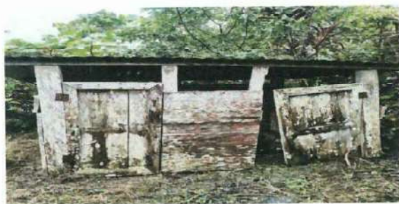
Foto 5: Puerta de baño esta en malas condiciones.
